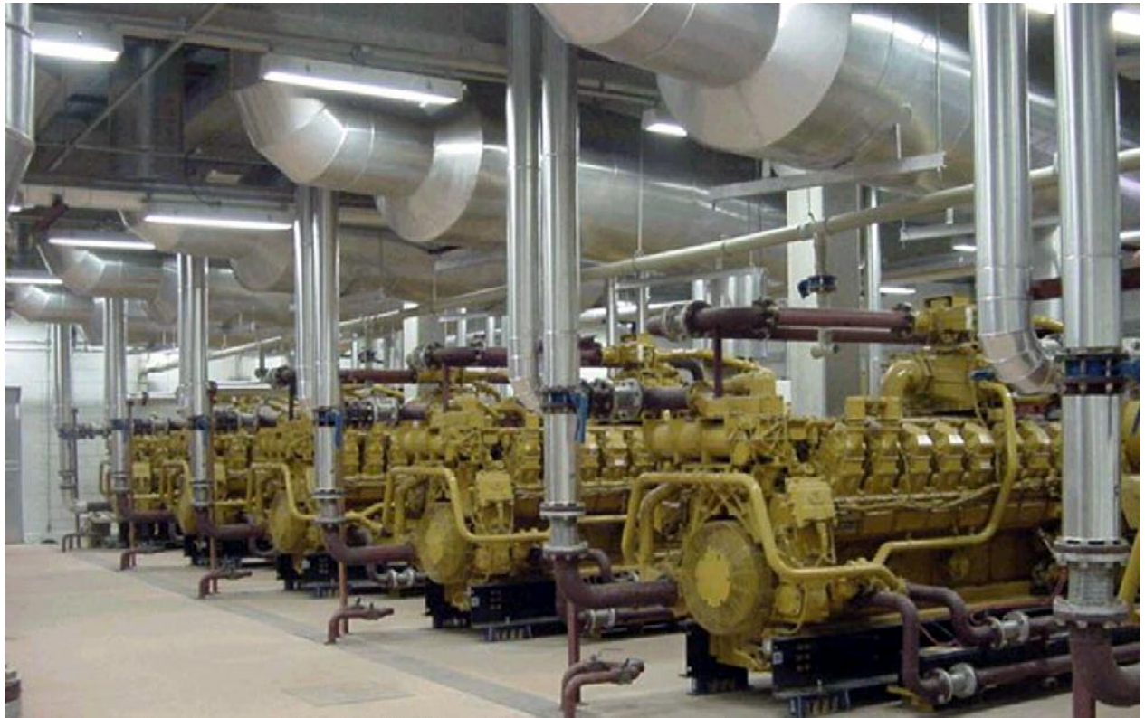
Abb. 3 Deponiegaskraftwerk auf „Bandeirantes Landfill“, Sao Paulo (ca. 22 MW)
