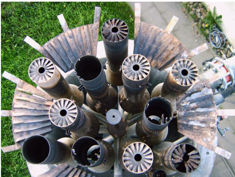
Abbildung 1: Beispiel Brenner mit beschädigten Brennerdüsen (1) [Foto: Stachowitz, 2005]
