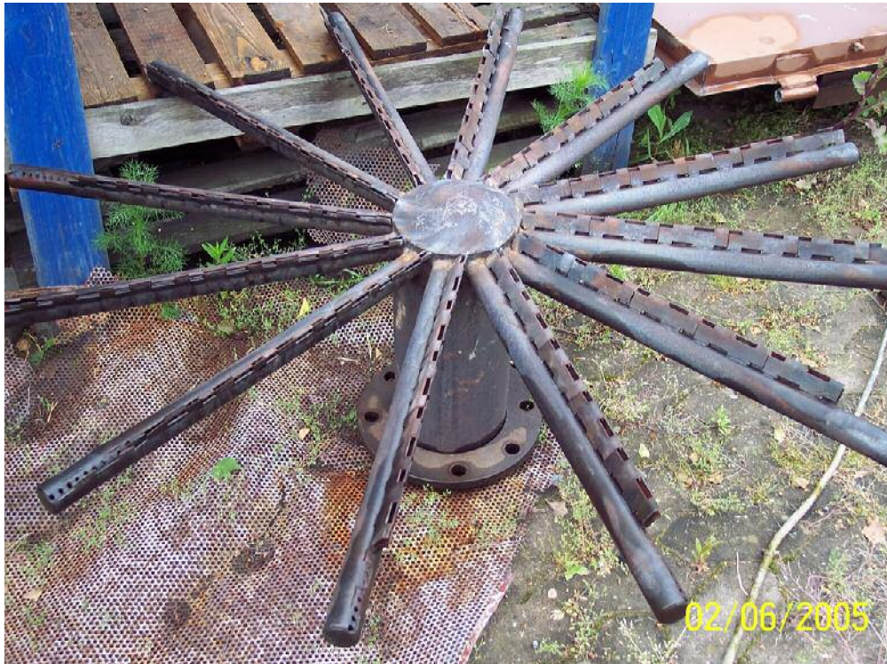
Abbildung 2: Beispiel Brenner mit beschädigten Brennerdüsen (2) [Foto: Stachowitz; 2005]
