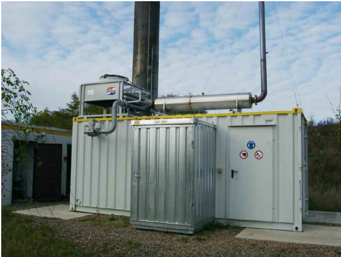
Abbildung 6 Deponiegas-BHKW mit Gasverdichter (Kompaktanlage 143 kWel)
