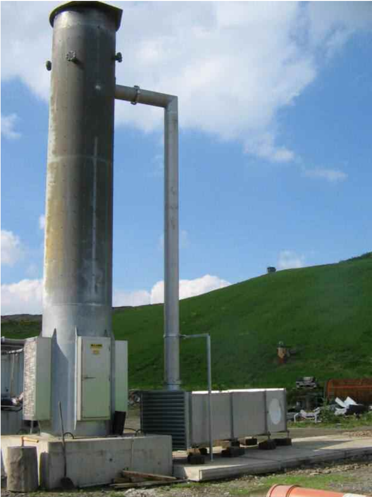
Abbildung 9 HAASE-Hochtemperaturfackel mit Wärmeauskopplung
