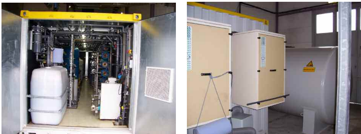
Abbildung 4 Neue Sickerwasserreinigungsanlage im Container Deponie Berg
