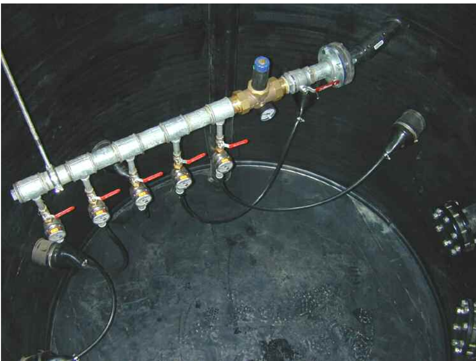
Abbildung 6 Bewässerungsschacht mit Wasserverteilungsbalken, Kugelhähnen, Wasseruhren und Druckminderern
