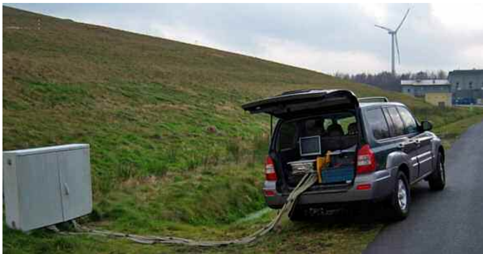
Abbildung 7 Feldverteiler mit Anschluss einer mobilen Auslese- und Auswerteeinheit (vergleichbare Anordnung auf einer anderen Deponiebaumaßnahme)
