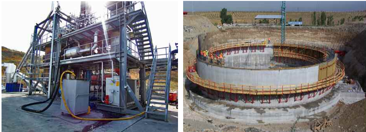
Bild 6 Pyrolyseanlage sowie in Bau befindlicher Fermenter auf einer Großdeponie
