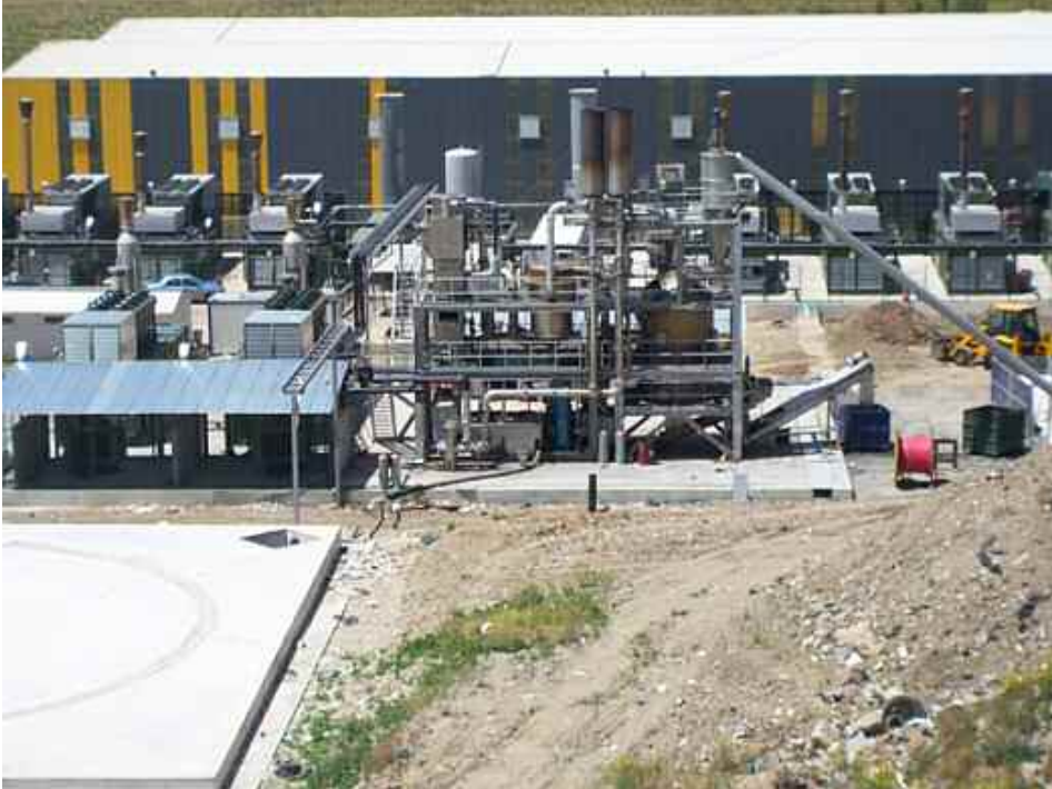
Bild 5 Anlage für die Deponiegasverstromung auf einer Großdeponie
