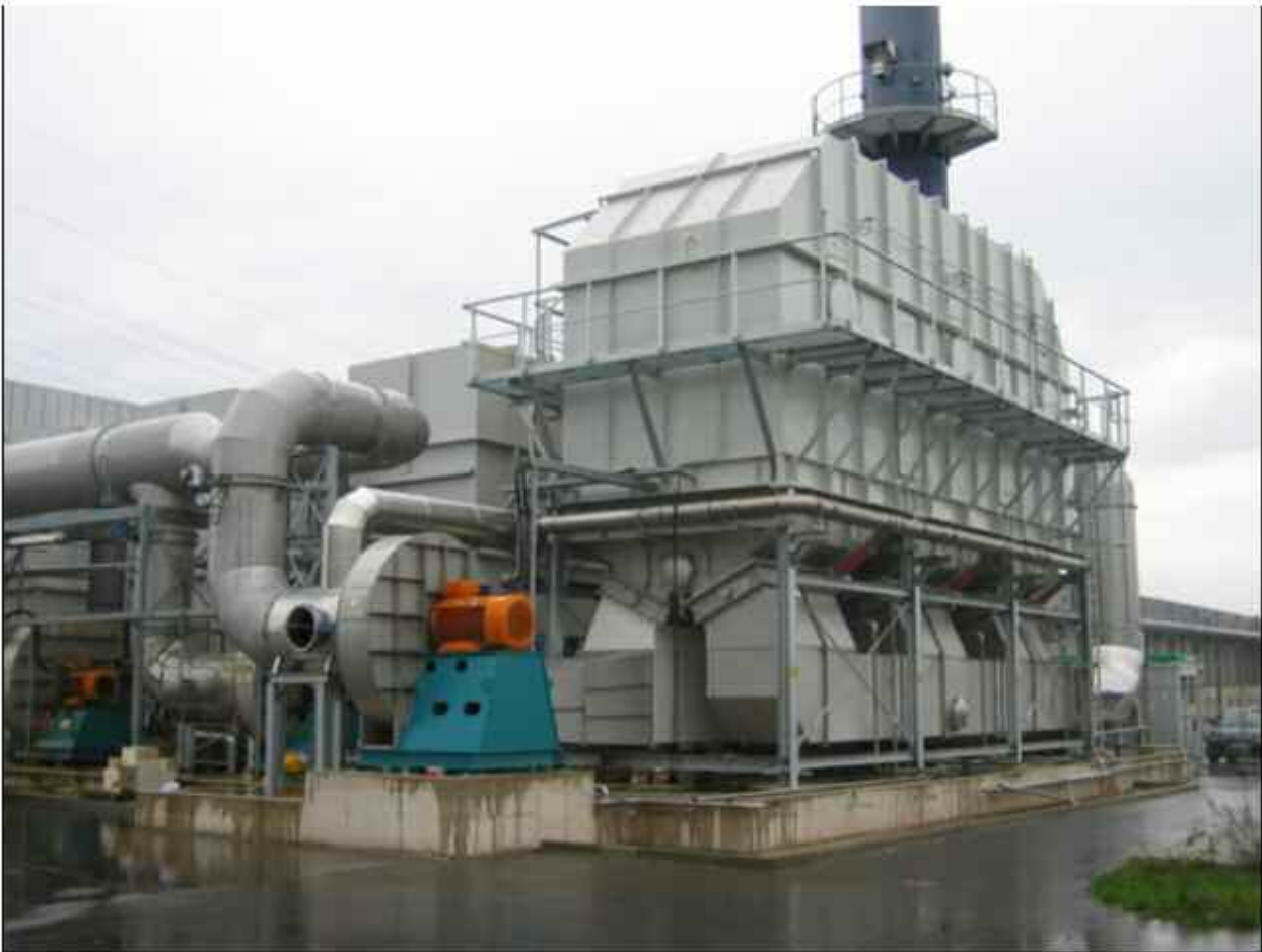
Abbildung 6: RTO-Anlage der neuesten Generation
