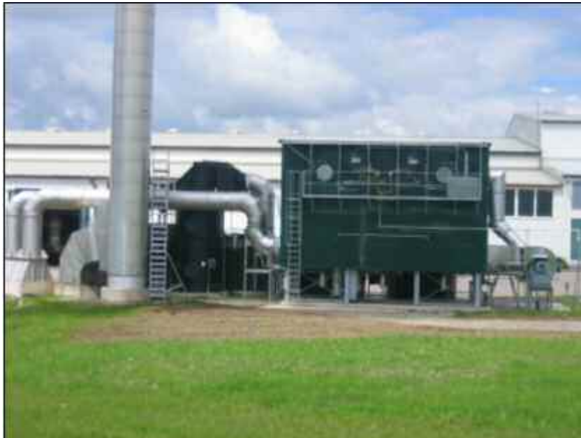
Abbildung 1: RTO-Anlage mit Wäscher
