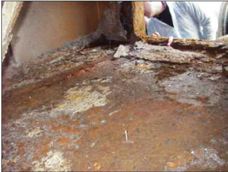
Abbildung 4: Korrosion im Rohgaskanal
