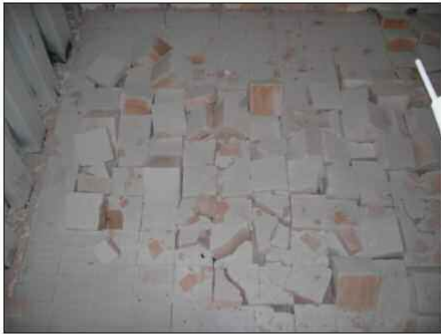
Abbildung 2: Siloxanproblematik in RTO-Anlagen, zerstörte Wärmetauscher
