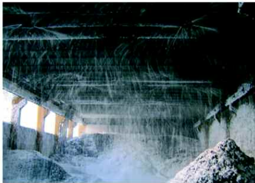
ONE SEVEN®-Löschanlage für die automatische Brandbekämpfung in einer Lagerhalle von Recycling-Produkten
